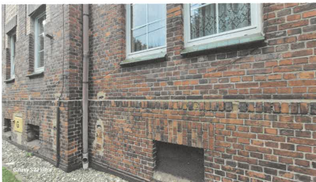
Fot. 11. Fragment elewacji, na którym widoczny jest stan cegieł i okablowanie; parapety wykonane z zielonego klinkieru
