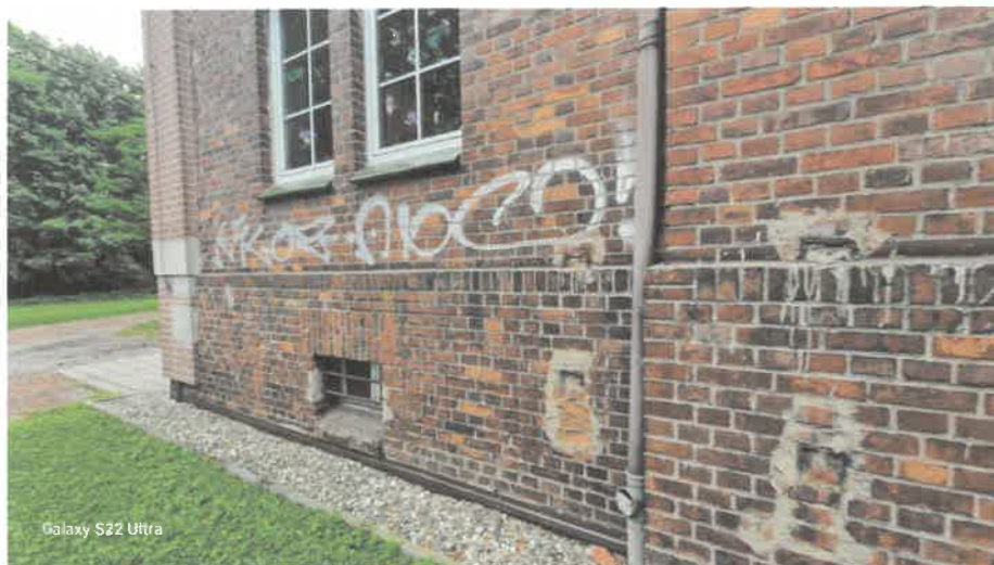
Fot. 10. Fragment elewacji z graffiti, parapety wykonane z zielonego klinkieru
