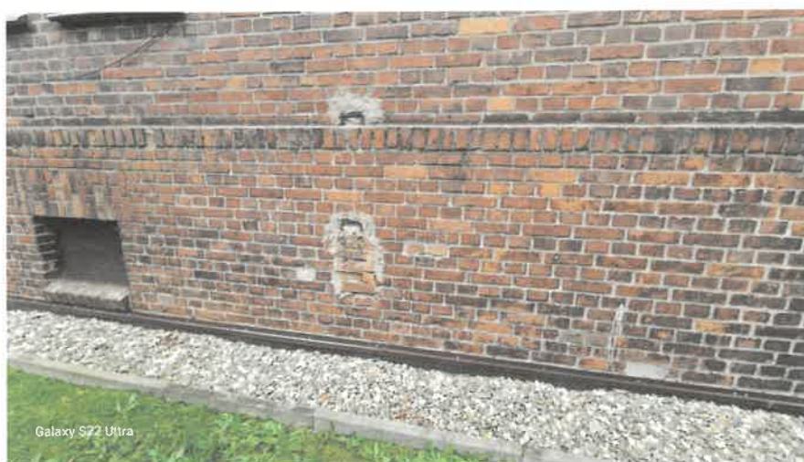
Fot. 8. Fragment elewacji, na którym widoczny jest stan cegieł
