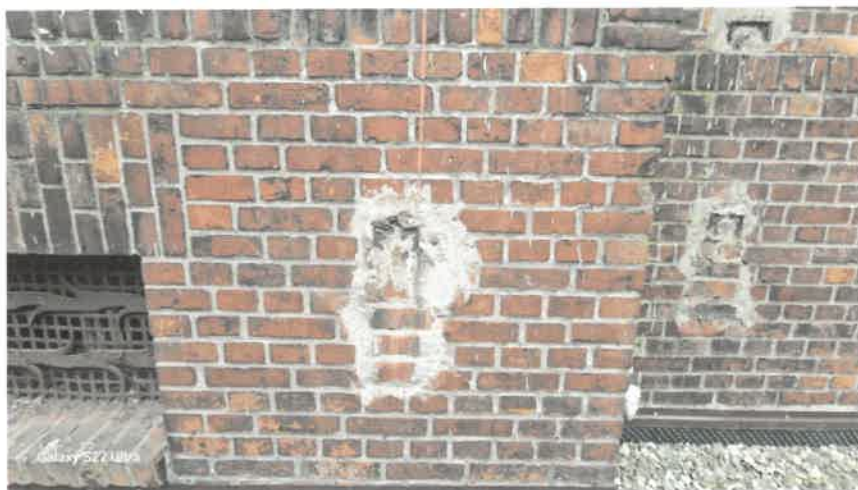
Fot. 6. Fragment elewacji, na którym widoczny jest stan cegieł
